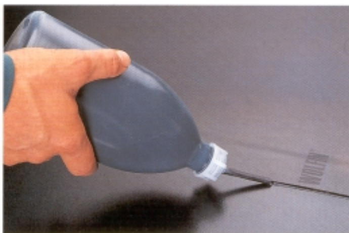
Obr. 13. Pojištění okraje sváru dvou PVC-P fólií pojistnou zálivkou. (Ukázka ze spojování fólií značky Wolfín).
