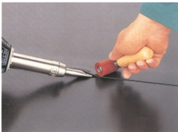
Obr. 12. Ruční horkovzdušné svařování fólií z PVC-P. Stlačení spoje se dosahuje převálečkováním. U větších ploch se používají svařovací automaty, které zajišťují vyšší kvalitu spoje. (Ukázka ze spojování fólií značky Wolfín).
