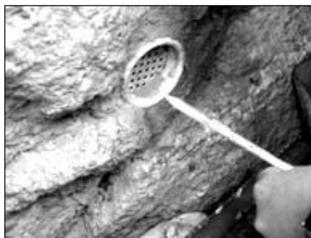
Obrázek č.1: Vstupní otvor podvětrávacího systému je zpravidla opatřen krycí mřížkou. Na fotografii je zobrazena kouřová trubička, která umožňuje pozorovat proudění vzduchu. V případě „oživení“ podvětrávacího systému aktivní ventilací je nutno tyto otvory zaslepit.
