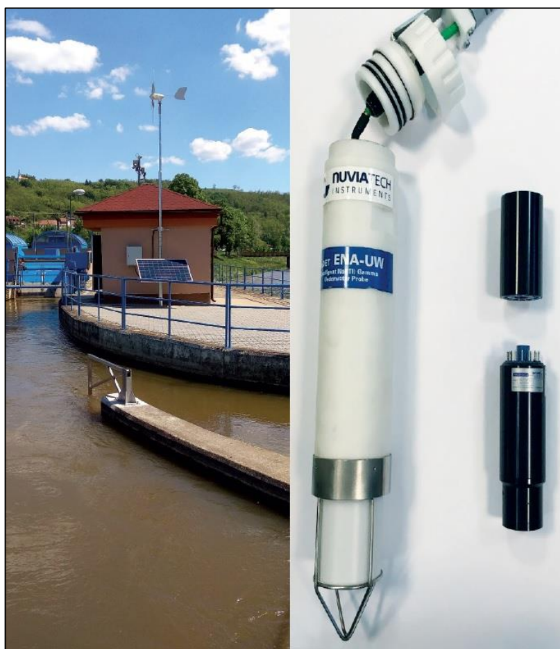
Obrázek 10: Automatická autonomní monitorovací stanice aktivity gama v povrchových vodách (Vlevo: ilustrativní fotografie zobrazující popisovaný systém v reálném provozu v lokalitě Ivančice. Vpravo: konstrukce detekční sondy)
